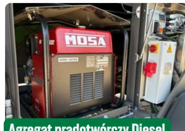
Agregat prądowórczy Diesel
